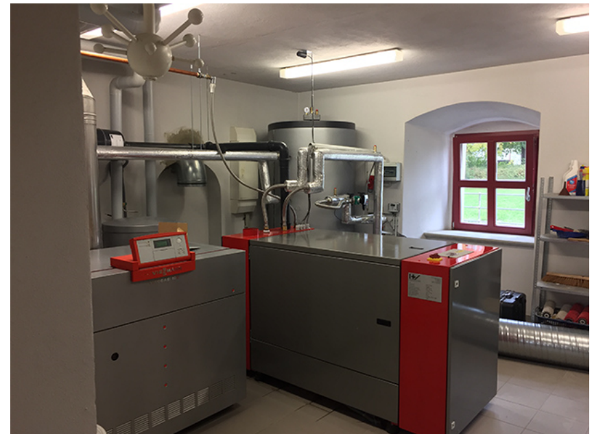
BHKW mit neuer Heizungsanlage
