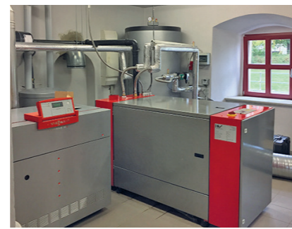
Blockheizkraftwerk BHKW Durch die gleichzeitige Erzeugung von Wärme und Strom wird die Effizienz erheblich gesteigert, 90% Energieausnutzung!
